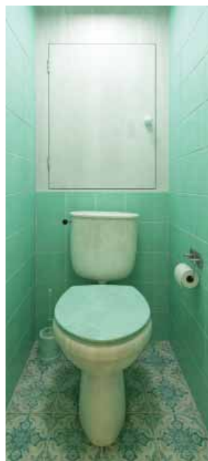
Panelákové WC před rekonstrukcí
